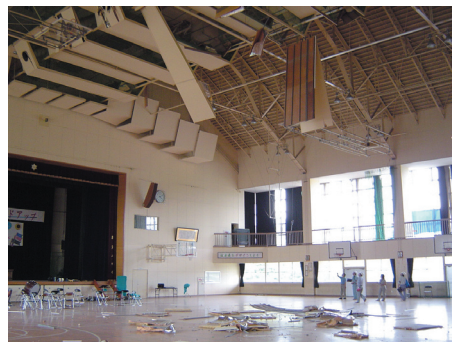
新潟県中越沖地震で被災した建物被害 (屋内運動場の天井材等の落下)
