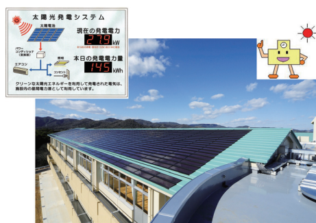
校舎屋根に40kWの太陽光パネルを設置し、発電量を表示。
