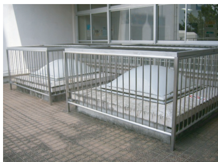
周囲に防護柵が設置された天窓 （本報告では参考として対策の一例を写真等により紹介）
