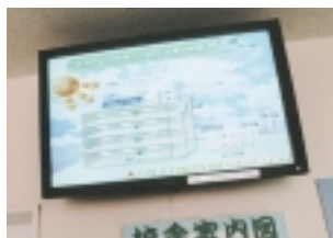
昇降口にある太陽光発電モニター
