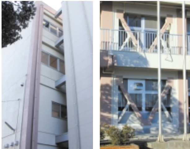
エレベータシャフトと耐震壁ブレース
