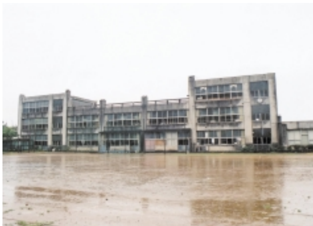
資料：学校施設の老朽状況
