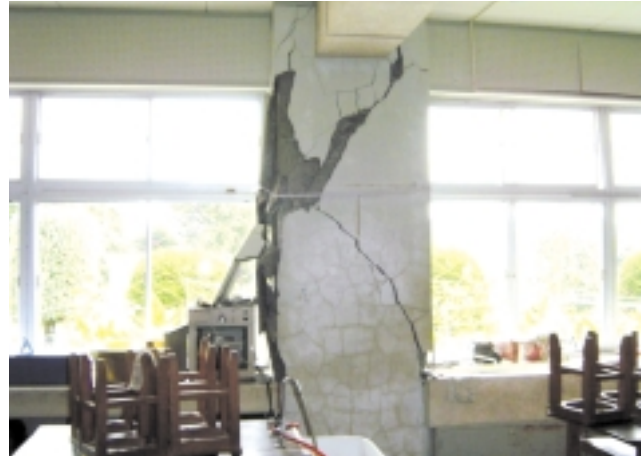
資料：地震による学校施設の被害（柱崩壊）
