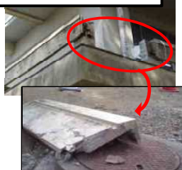
老朽化したベランダに生徒が寄りかかり、落下してケガ
