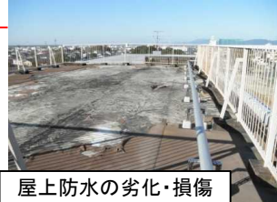
屋上防水の劣化・損傷
