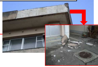
外壁モルタルの落下
