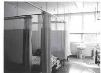
狭く老朽化した6人床の病室
