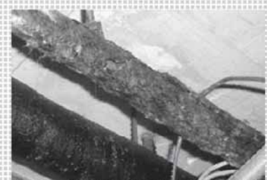
▲給水管の漏水 屋内給水管(経年39年)
