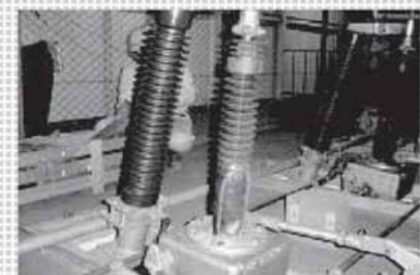
▲全学停電 特高受変電設備(経年27年)
