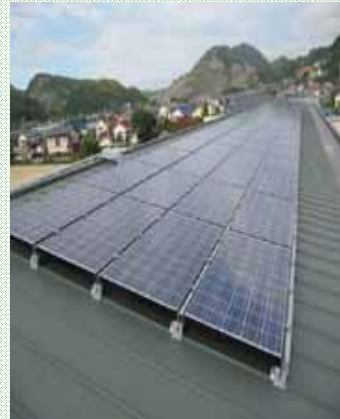
太陽光パネル
