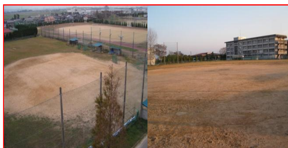
既設表層の全面撤去及び新たな混合土を敷き均す工法
