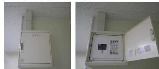
製造者標準ホーム分電盤 25面 (工事費4,831千円)
