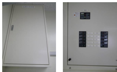
製作用分電盤 25面 (工事費7,240千円)
