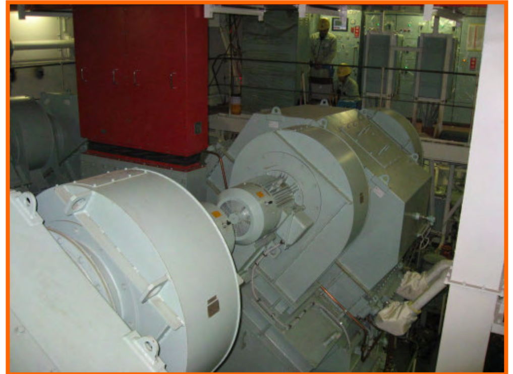
推進電動機室(11月7日)
