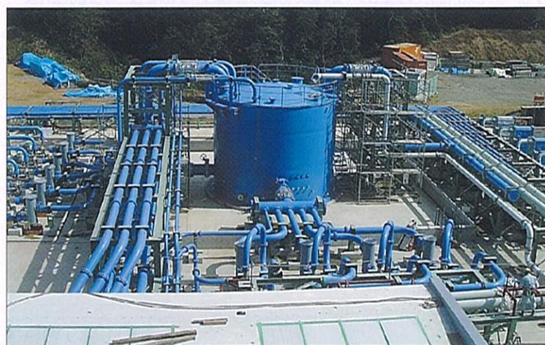
主油タンク：205KL (平成15年3月撮影)
