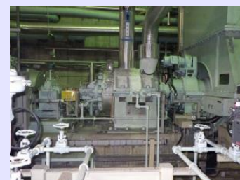
主給水ポンプ
