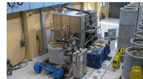
スラッジ、ホウ素、樹脂などの 既存廃棄物・物質を調整する ための可搬式装置の展開
