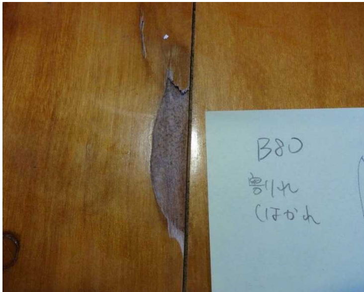
図 12 塗装・床材の剥離
