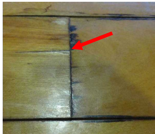
図11 短辺部分に発生した割れ
