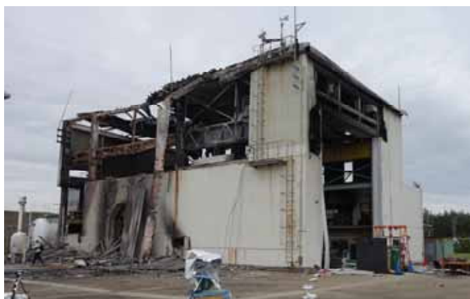
真空燃焼試験棟(爆発後)
