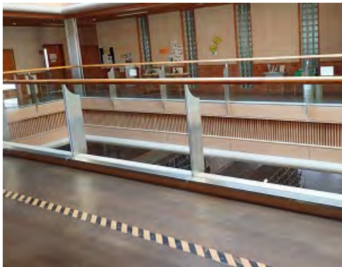
写真 31 転落の危険がある吹き抜け（学校 A）
