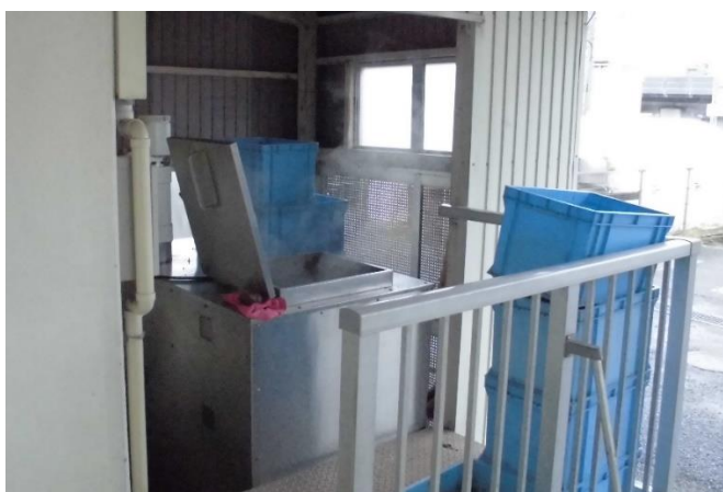
○給食センターに設置している生ゴミ発酵処理装置
