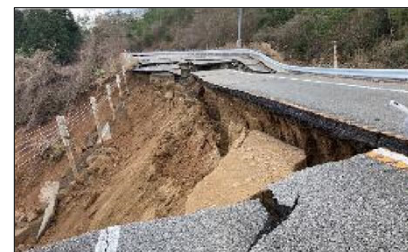
道路被災(陥没・路肩決壊) のと里山海道(国土交通省HPより)
