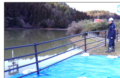
農業施設被災(ため池堤体) 珠洲市(農林水産省HPより)
