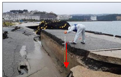
港湾施設被災(液状化・沈下) 能登町宇出志港(国土交通省HPより)
