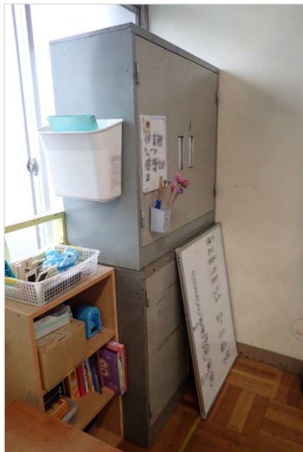
写真 18 固定されずに積み重ねられたロッカー (学校 B)
