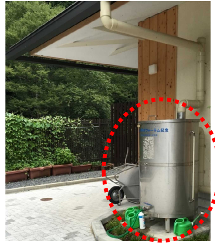
雨水タンクを設置し、プランターの水やりに活用（京都府京都市立八瀬小学校）
