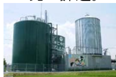
バイオガス発電
