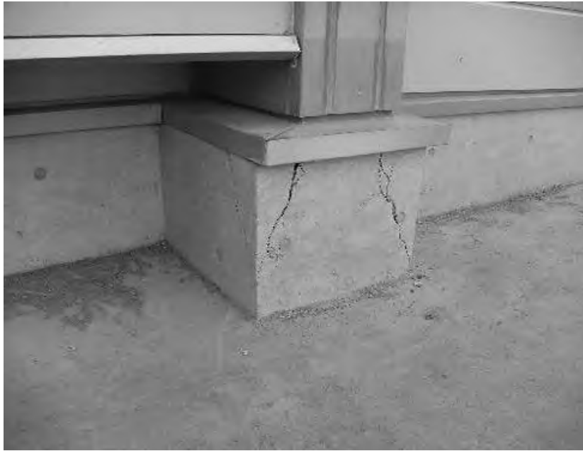
写真 4.4 新耐震設計基準の体育館で発生した露出型柱脚における側方破壊
