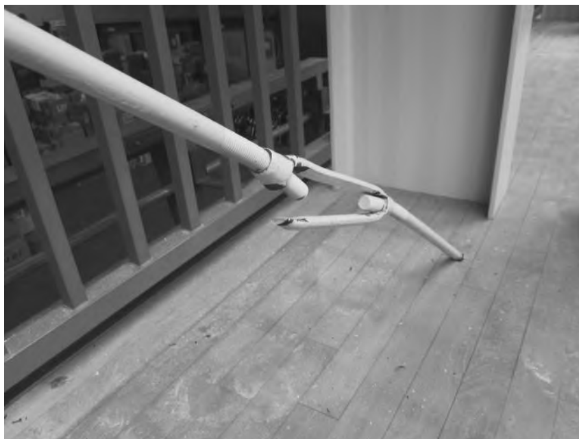
写真 4.1 新耐震設計基準の体育館における建築用 JIS ターンバックルでないターンバックルブレースの早期破断
