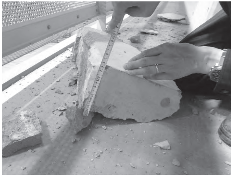
写真 4.6 鉄骨置屋根定着部における側方破壊
