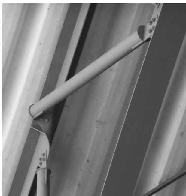
写真 4.2 新耐震設計基準で建てられた建物における鋼管に一枚のガセットプレートが割り込まれた筋かいの座屈
