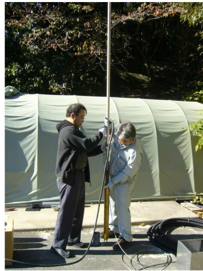
図 2: 愛知県豊橋市 (名古屋大学三河地殻変動観測所) でのポアホール型 3 成分加速度計の設置作業。
