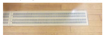
床面の吹き出しスリット
