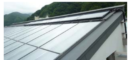
集熱パネル(集熱面積507.4m 2 ) 上段は太陽光発電パネル
