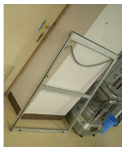
落下した障子
