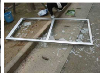
落下して破損した障子
