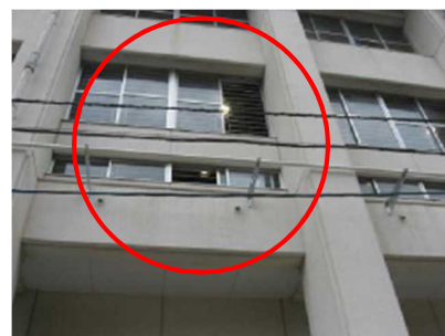
障子の落下箇所
