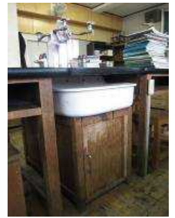
度重なる配管の破損
