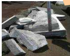
老朽化により モルタルが落下
