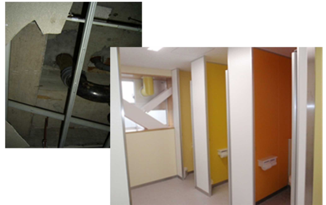
図2 左：漏水している便所配管 右：補修後の便所
