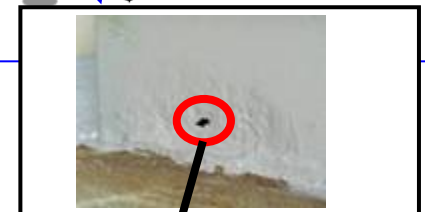
腐食孔を確認(平成20年9月9日) (大きさ:縦約1cm 横約2cm)
