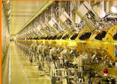
リニアック棟加速器トンネル (平成18年11月からビーム試験開始)
