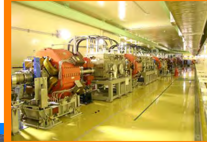
3GeVシンクロトロントンネル (平成19年10月からビーム試験開始)
