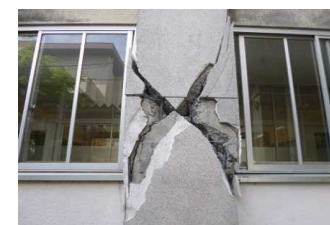
耐震化未完了の建物に甚大な被害
