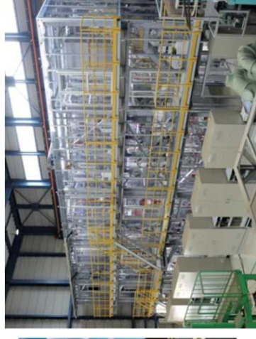
連続水素製造試験装置
