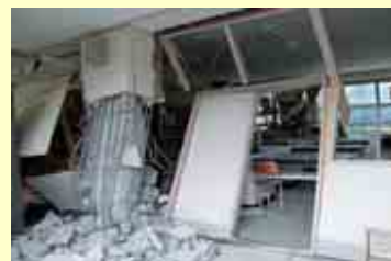
地震により崩壊した教室の柱 (福島県本宮市)
