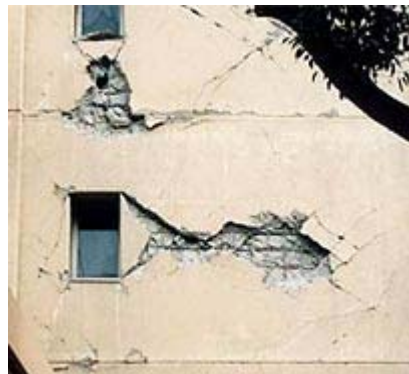
壁せん断破壊
