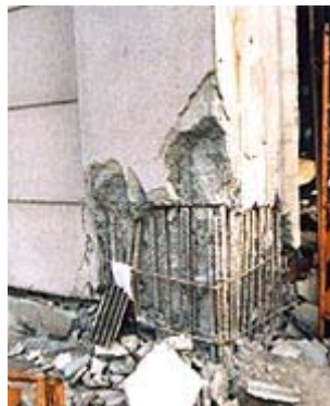
柱付着割裂破壊
