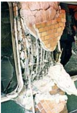
柱せん断破壊
