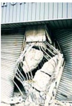
柱せん断破壊
