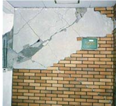
壁せん断破壊
