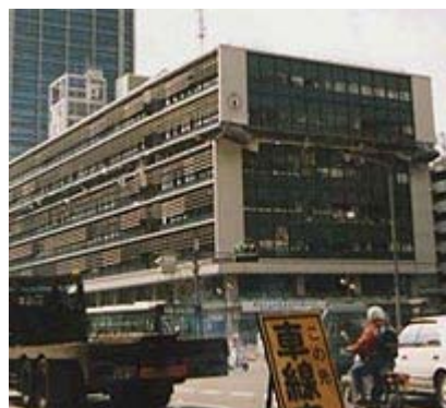
柱破壊による中間階の崩壊
