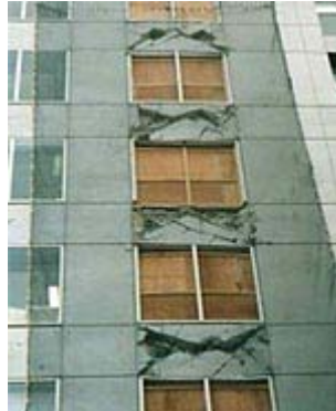
梁せん断破壊
