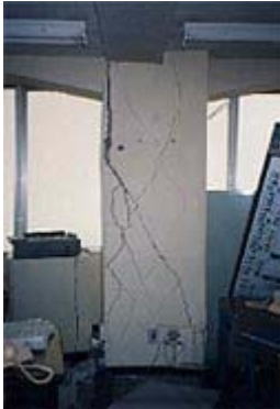
柱せん断破壊
