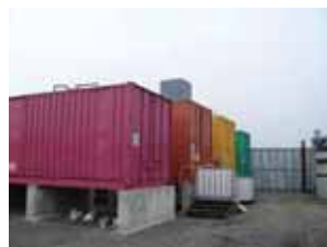
筑波バイオエコシステム協同組合の実証プラント
