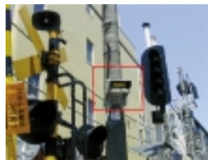
知的踏切監視システム
