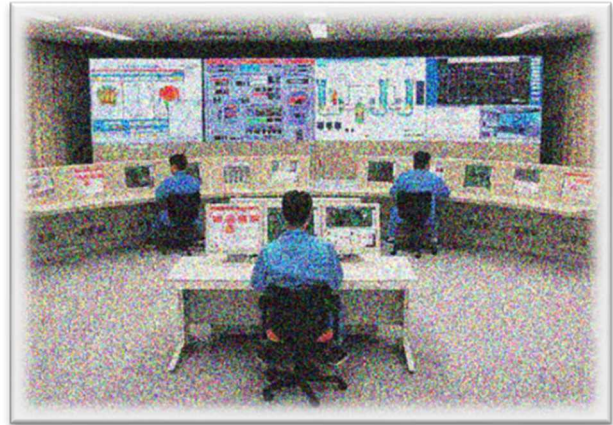
写真 6 : 深層防護の体験的研修 に用いたプラントミュレータ
