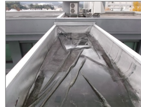
屋上防水の劣化による浸水!!
