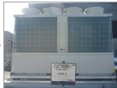
チラーユニット（更新後）
