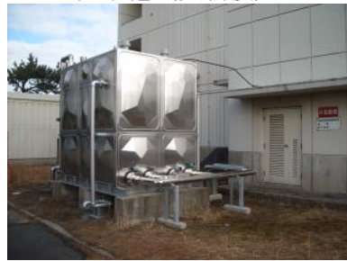
受水槽（更新後）
