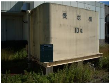
受水槽（更新前）
