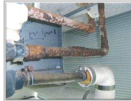
配管の破損による漏水!!
