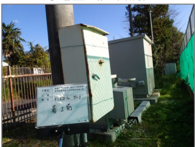
分電盤（更新前）
