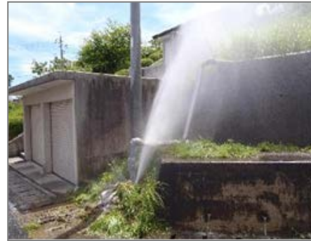
給水管の破損による断水!!
