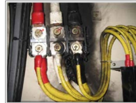
電気設備の故障による停電!!
