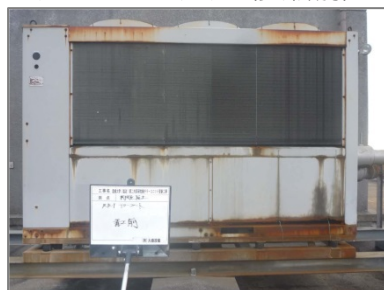
チラーユニット（更新前）
