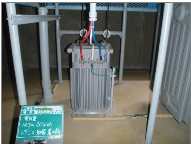
変圧器（更新前）
