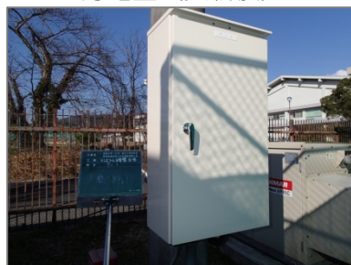
分電盤（更新後）
