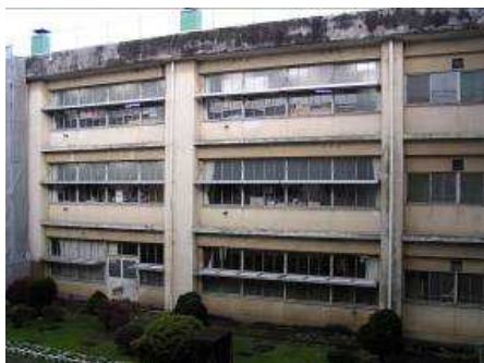
外装材の著しい劣化
