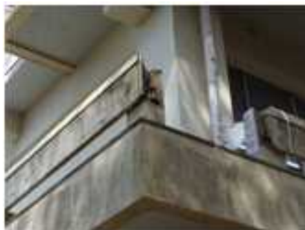
老朽化による手すりの落下
