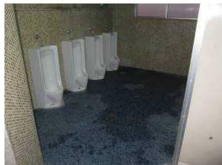
トイレの老朽化による臭気の発生
