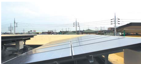
7 太陽光パネル
