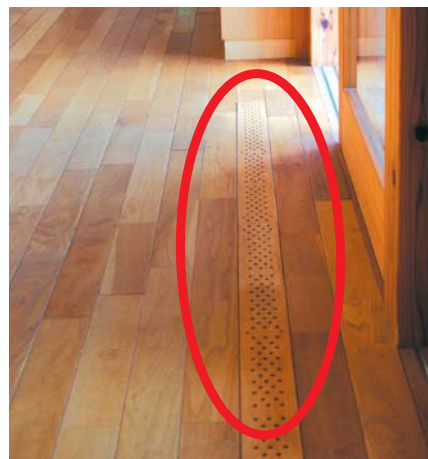
11 床吹き出し口
