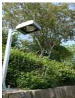
【写真1】 構内と最寄り駅までの通学 路に設置した外灯
