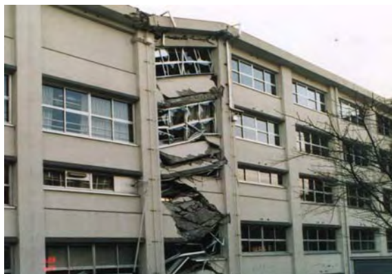
地震による被害状況
