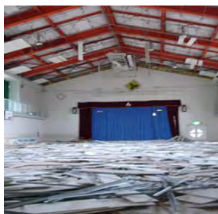
天井材の落下被害事例
