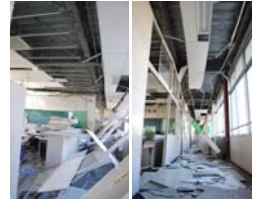
茨城大学(天井材の落下等)
