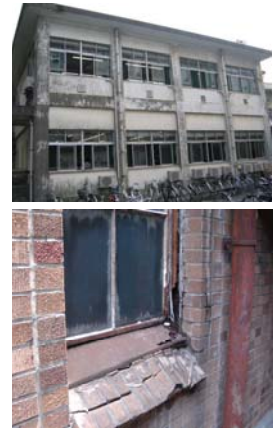
安全性や省エネ性能の著しく低い老朽施設
