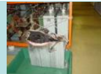
焼損したコンデンサー
