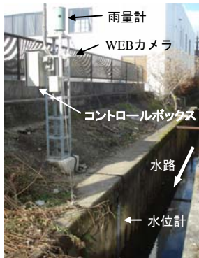
計測機器設置例(壺川校区)
