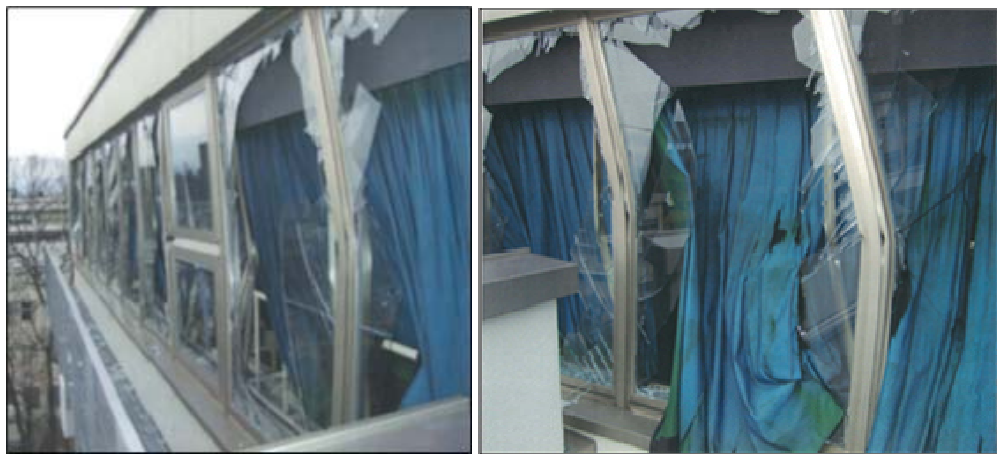
(ハットNE(50周年記念館)における窓枠等の損壊状況)
