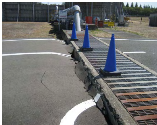
(図H) 構内道路の沈下
