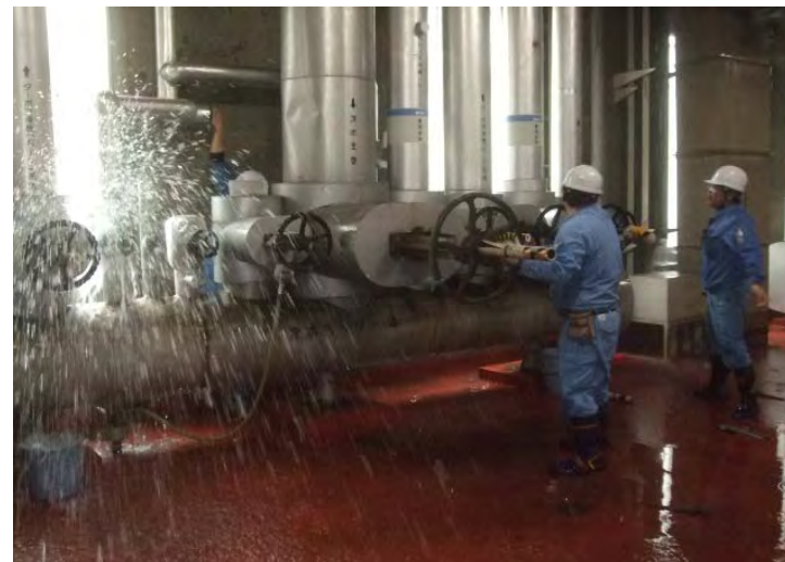
(図A) 動力棟 冷水・温水配管破損
