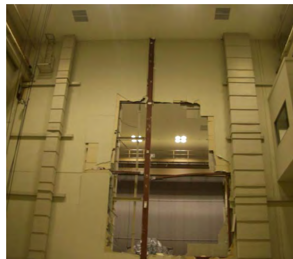
(図B) 総合環境試験棟 壁破損落下
