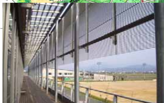
省エネルギー ルーバーによる日照の調整
