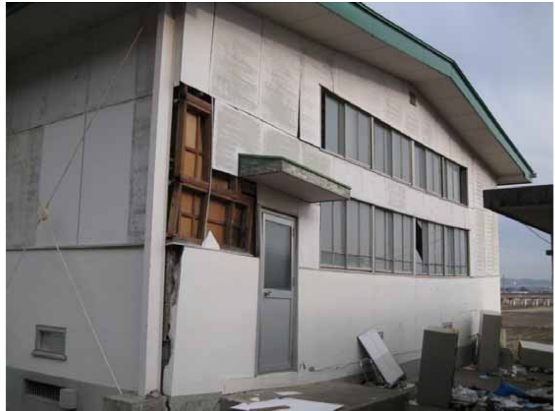
武道場外壁剥落
