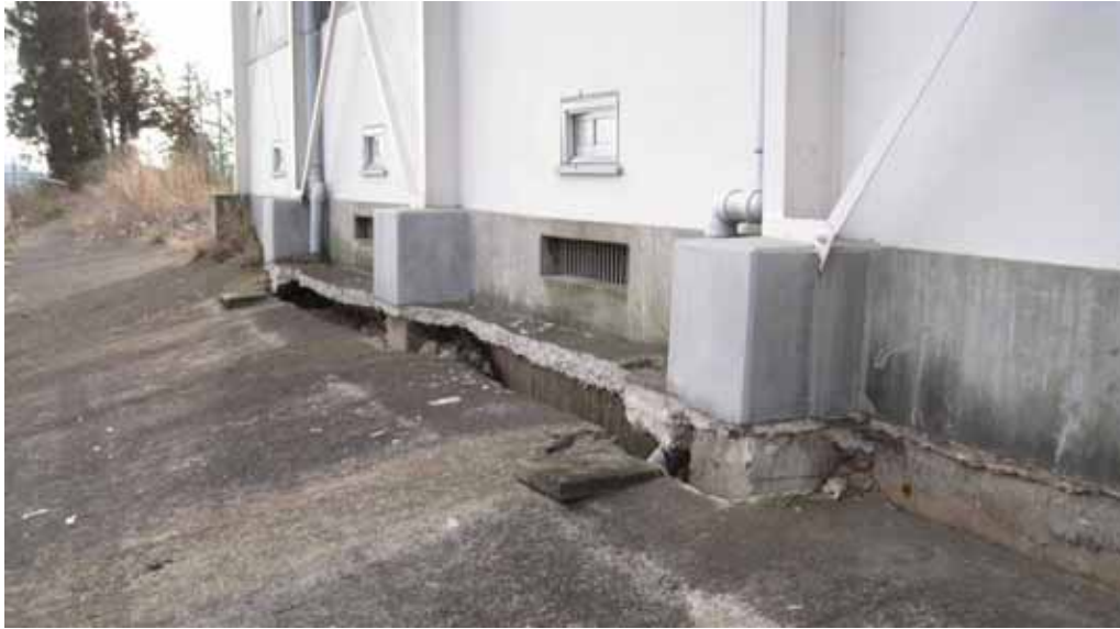
武道場地盤沈下
