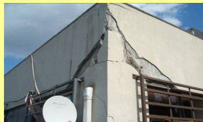
外壁が剥がれ落ちた校舎
