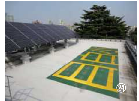
▲屋上に設置された太陽光パネルとヘリサイン。
