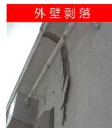
■外壁 経年46年 外壁が経年劣化により亀裂を生じ剥落。
