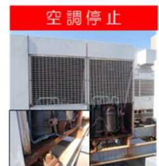
■空調機 経年23年 内部部品が腐食したため、温度調節ができない状態。
