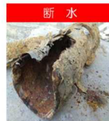
■排水管 経年36年 劣化により腐食、破損し、排水が漏洩。
