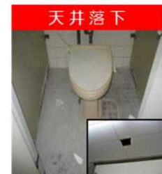
■床スラブ 経年31年 上階の便器固定用モルタルの落下により、天井を突き破り床まで落下。
