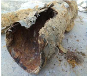
排水管(経年36年) 劣化により腐食、破損し、 排水が漏洩
