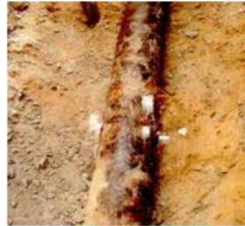
ガス管(経年32年) ガス管の腐食によりガス 漏れが生じたため、停止
